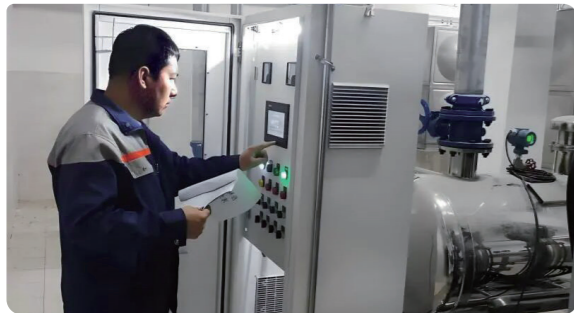
進行日常設備檢查
